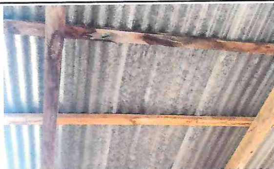
Foto 3: Costaneras y laminas deterioradas en las aulas
