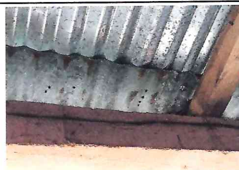
Foto 6: Láminas en mal estado por filtracion de agua.
