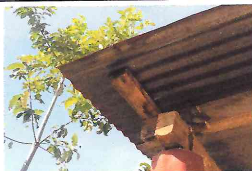
Foto 2: Costaneras de maderas deterioradas por el agua
