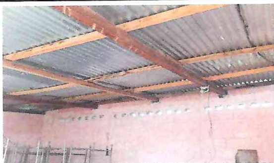
Foto 5: costaneras que se encuentran dañadas por goteras
