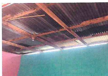
Foto 4: Láminas y costaderade madera en mal estado
