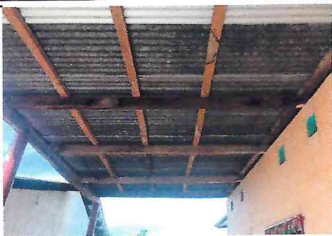
Foto1: Techo deteriorado por el agua y el tiempo
